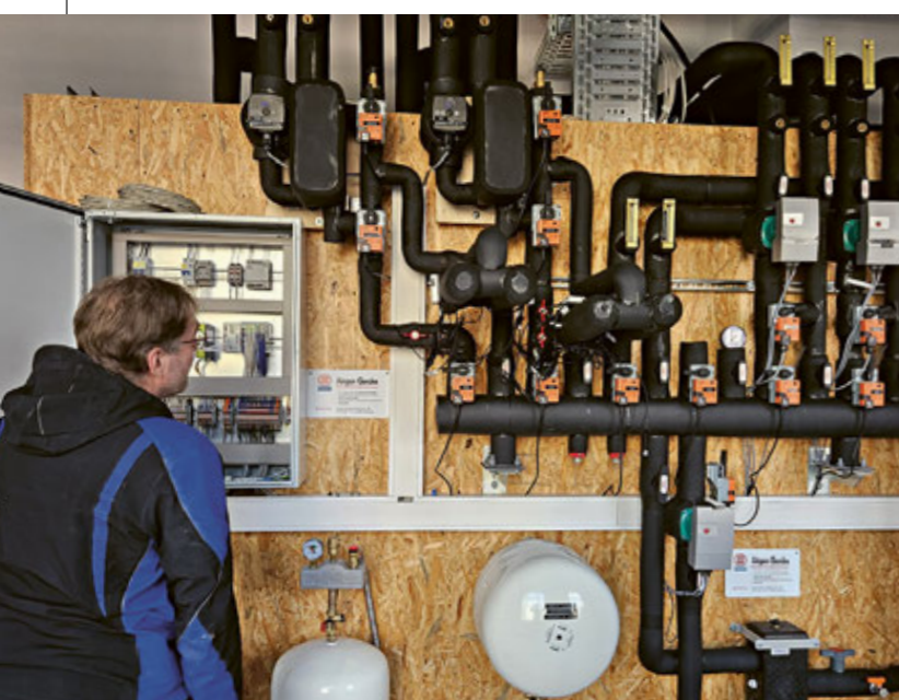
IN DER VERTEILERSTELLE wird das jeweils optimale Mischungsverhältnis der Wärmeträger im energetischen Gesamtsystem hergestellt.
